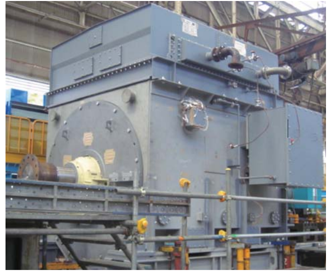
5 25-MW synchronous motor
