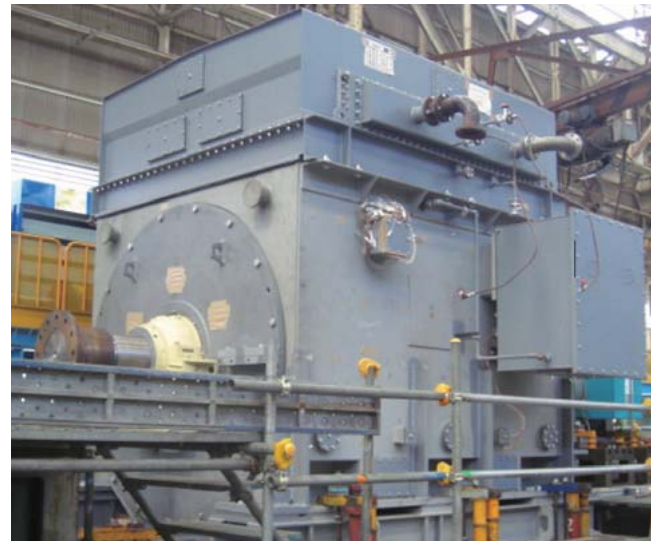
5 25-MW synchronous motor
